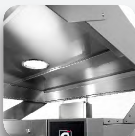
Conducto humos y campana.
